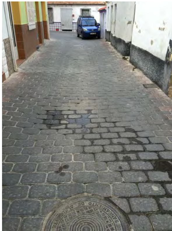
Imagen 5. Calle Morón Pozo 11 P.K. 0+219
