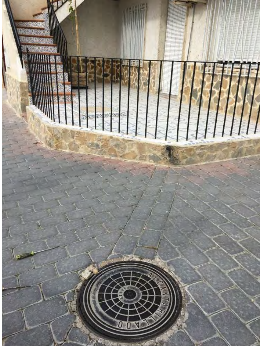
Imagen 1 Calle Morón Pozo 8 P.K.0+161
