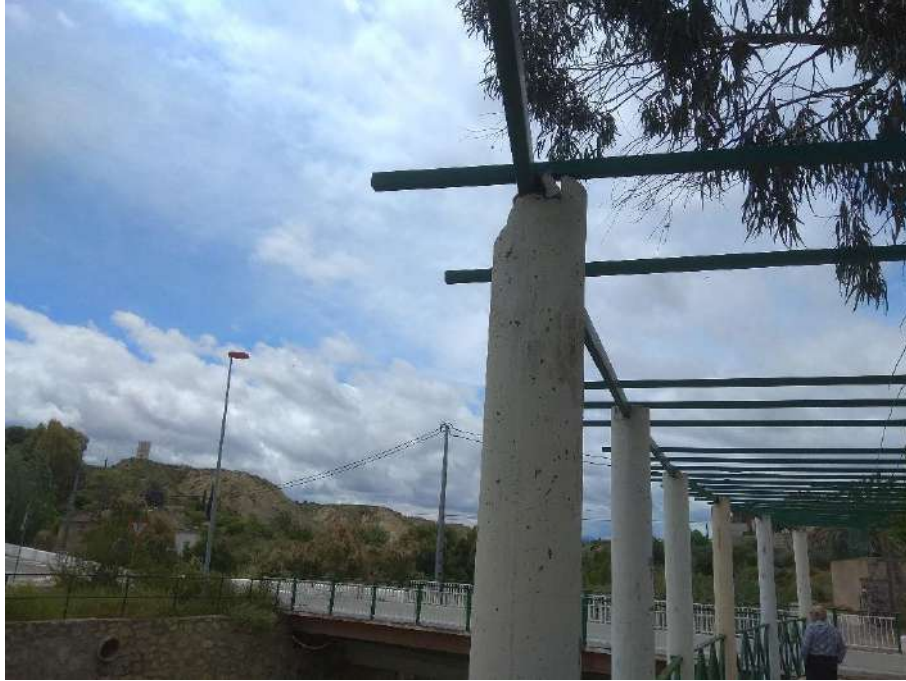
Fotografía nº 7. Pilares con riesgo de desprendimiento.
