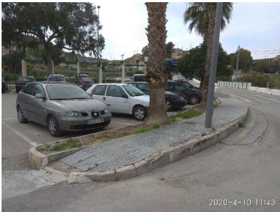
Fotografía nº 4. Estado actual aceras en mal estado.
