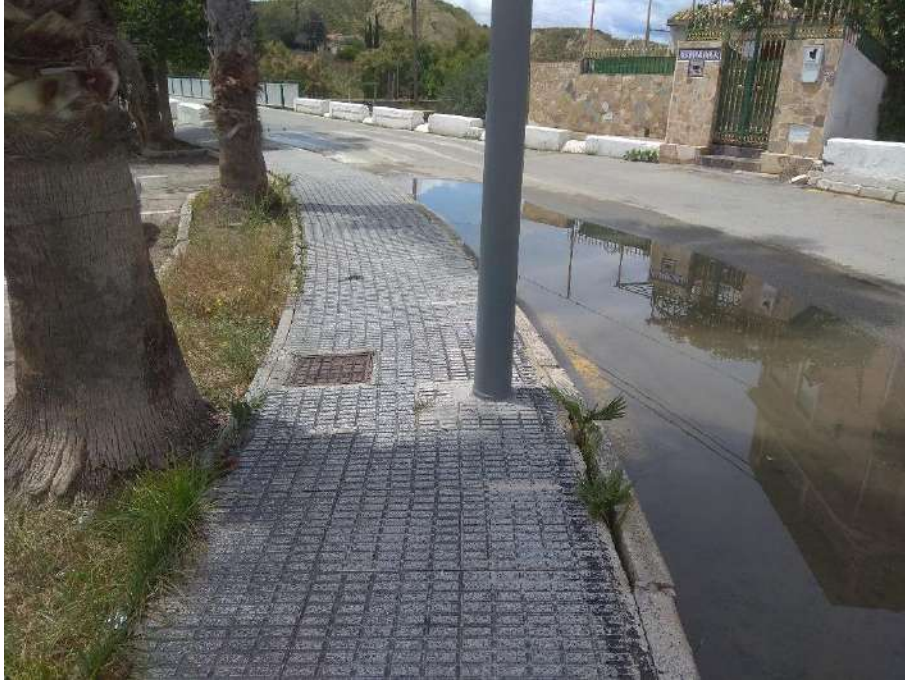
Fotografía nº 5. Aceras en mal estado.
