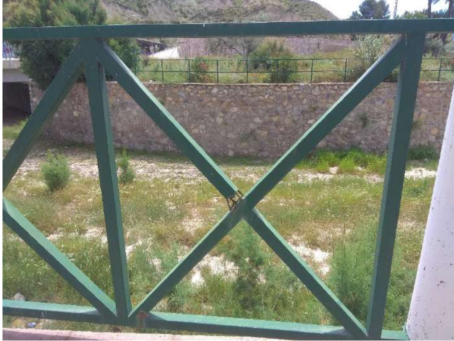
Fotografía nº 9. Barandillas en mal estado.
